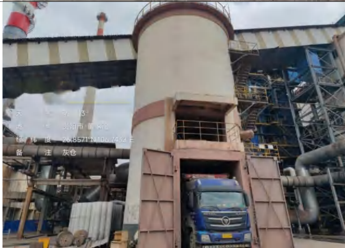
图 4-5 脱硫石膏仓及灰仓
