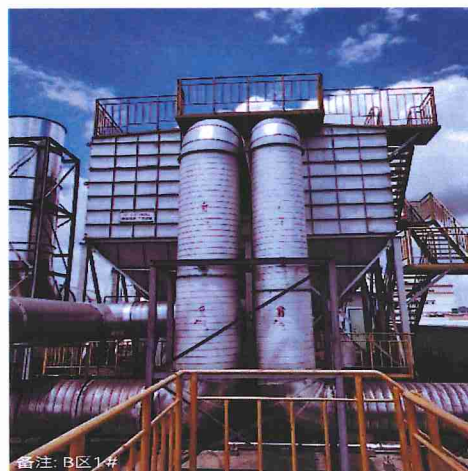
废气处理设备（B区1#）
